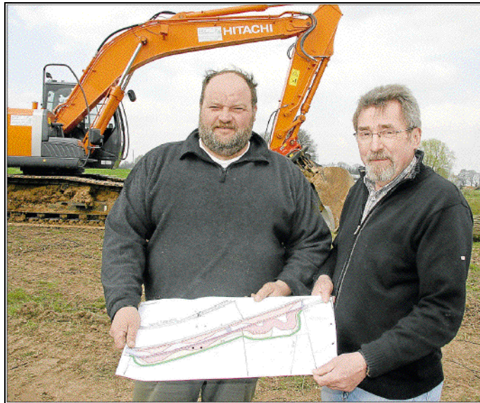
Zeigen die Pläne zur Ems-Renaturierung: Unternehmer Thomas Brummel (links) und Heinz Brenke von der Kreisverwaltung. Die Arbeiten zur naturnahen Umgestaltung der Ems in Greffen haben vor einer Woche begonnen. Abgeschlossen sein sollen sie im Juli, spätestens aber im August. Bilder: Frerick
