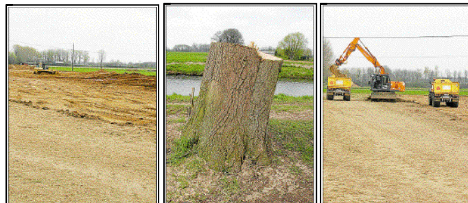
Gut 40 Meter sind es vom bisherigen Emsufer bis zum gerade entstehenden neuen Wall.
